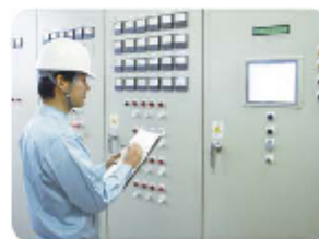
制御監視システム
