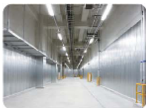
省エネ型LED照明
